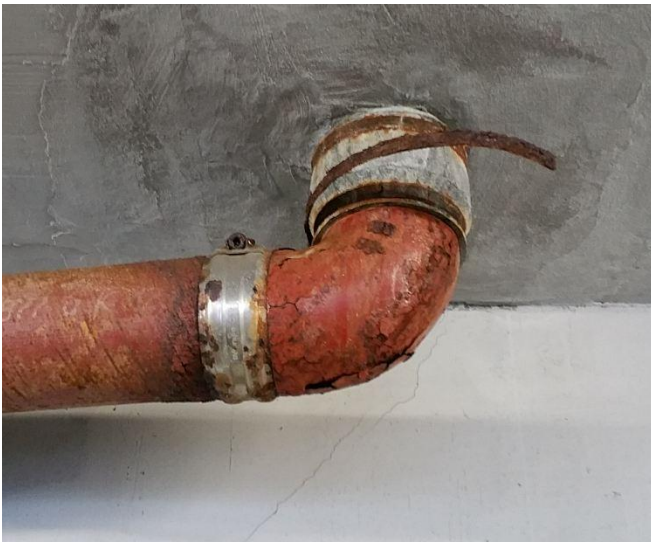
Abb.-1 Problematik: Verbindung zwischen korrodierter Anschlussleitung aus SML und Bodenablauf aus HT mittels korrodiertem Sonderübergangsstück. Foto: Mücher Dichtungen
